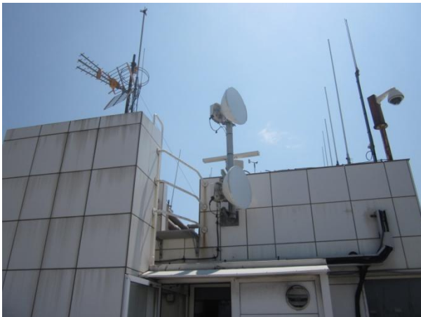
Figura 4.2.13 Otros consumidores – Equipos de control
