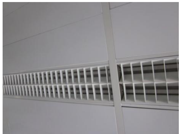
Figura 4.2.7 Fluorescencia lineal del edificio de Port Control
