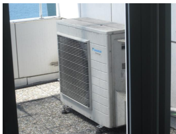
Figura 4.2.10 Bomba de calor – Unidad exterior
