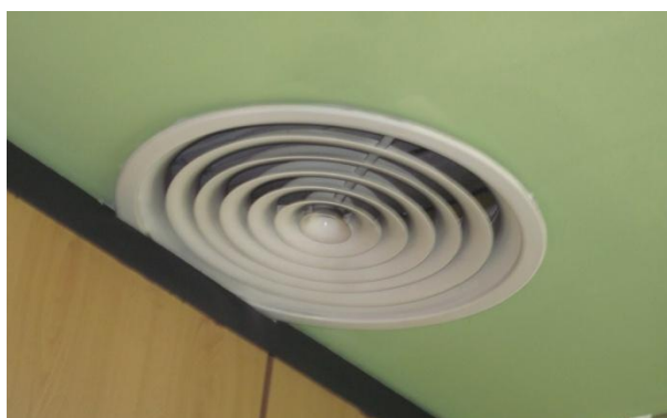
Figura 4.2.9 Difusor de techo
